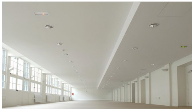
GOED VOORBEELD - klimaatplafond met onzichtbare functie
