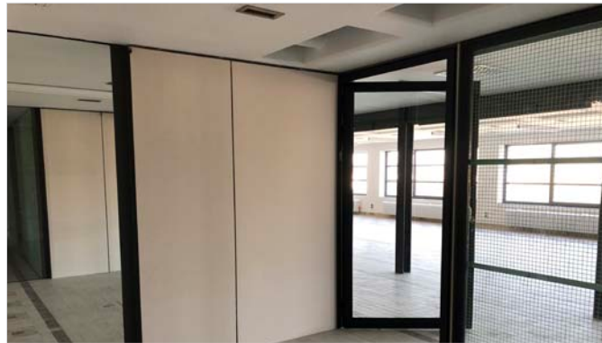
Akoestische panelen tussenwanden +2 en +3 in Abet Laminati 0409 SEI
