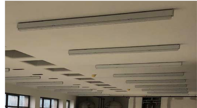
LED-armaturen op +2 (en op +3 identiek)
