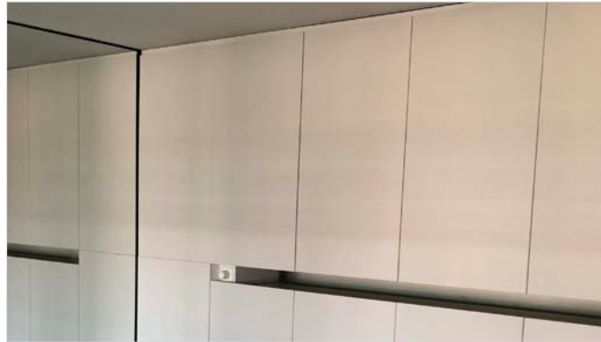
Akoestische panelen kastenwand +2 en +3 in Abet Laminati 0405 SEI
