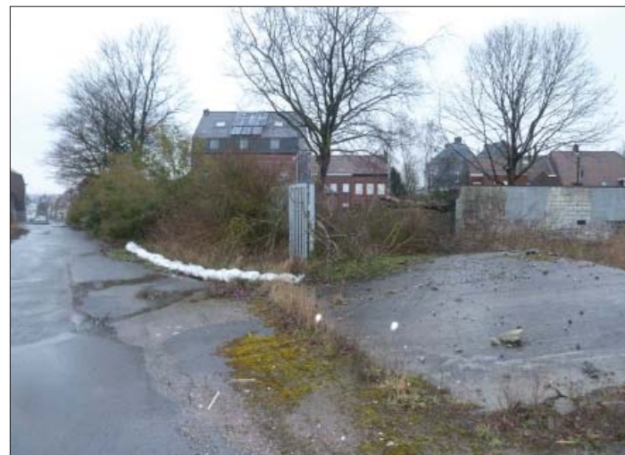
DE HUIZEN LANGS DE SPOORWEGSTRAAT ZIJN LAGER GELEGEN EN ONDERVINDEN MOMENTEEL OVERLAST VAN AFSTROMEND HEMELWATER
